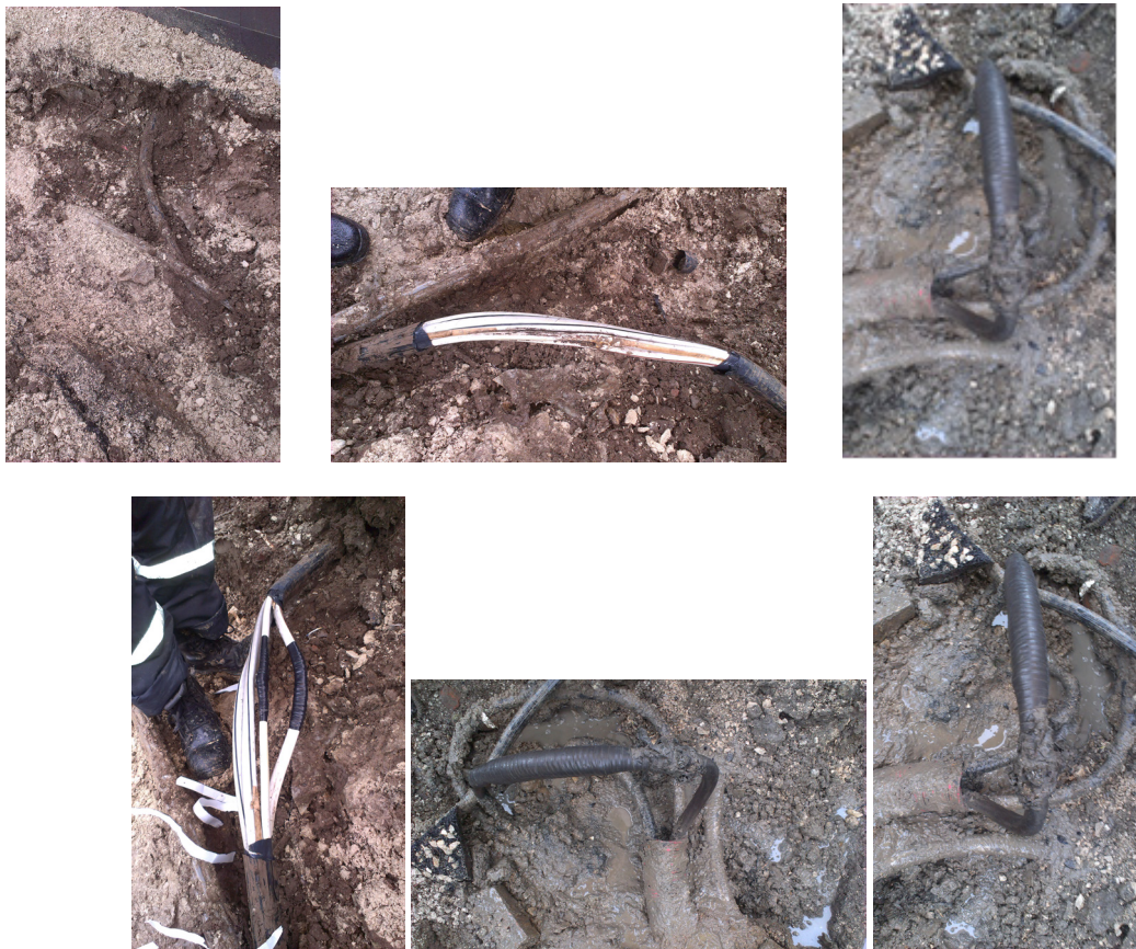
Фигура 8. Снимки от отделните етапи на достигане на мястото на повредата и пробият кабел.
